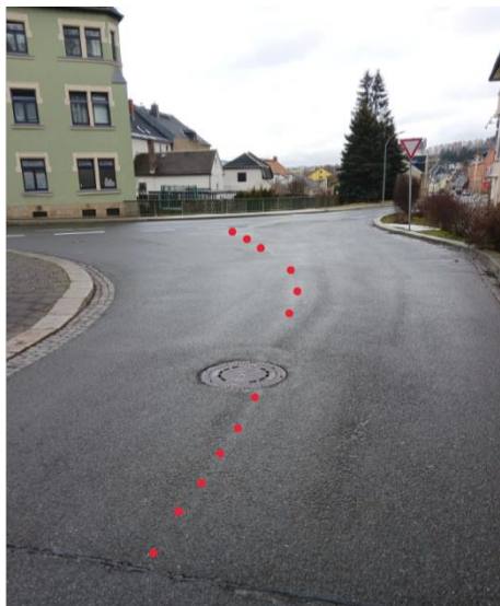
Markierung Marktplatz, Kreuzung zur Hauptstraße (Markierung ist nur noch sehr schlecht zu sehen / Erneuerung)
