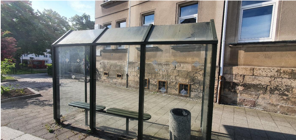
Bushaltestelle vor der Reinigung
